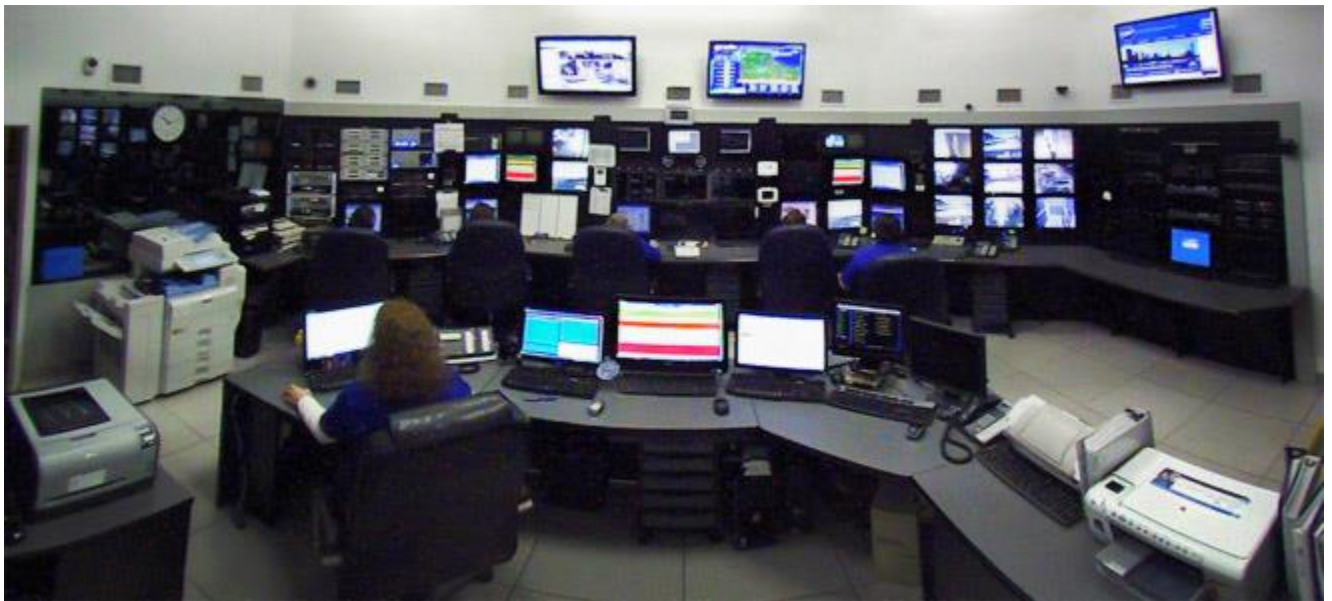
Εικόνα 45 Σταθμός - Εργαζόμενοι Κέντρου λήψεως
