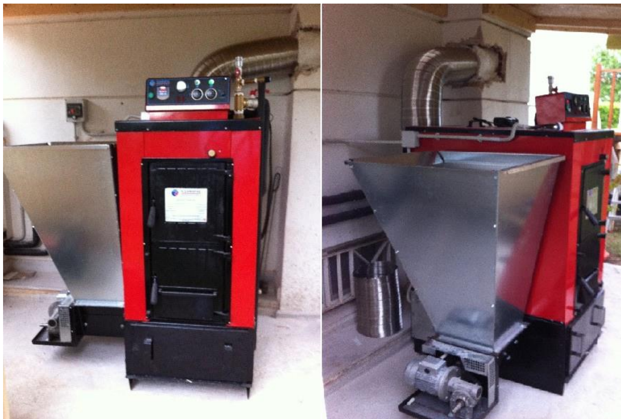
Εικόνα 21 Σύστημα θέρμανσης αξιοποιώντας τη βιομάζα
