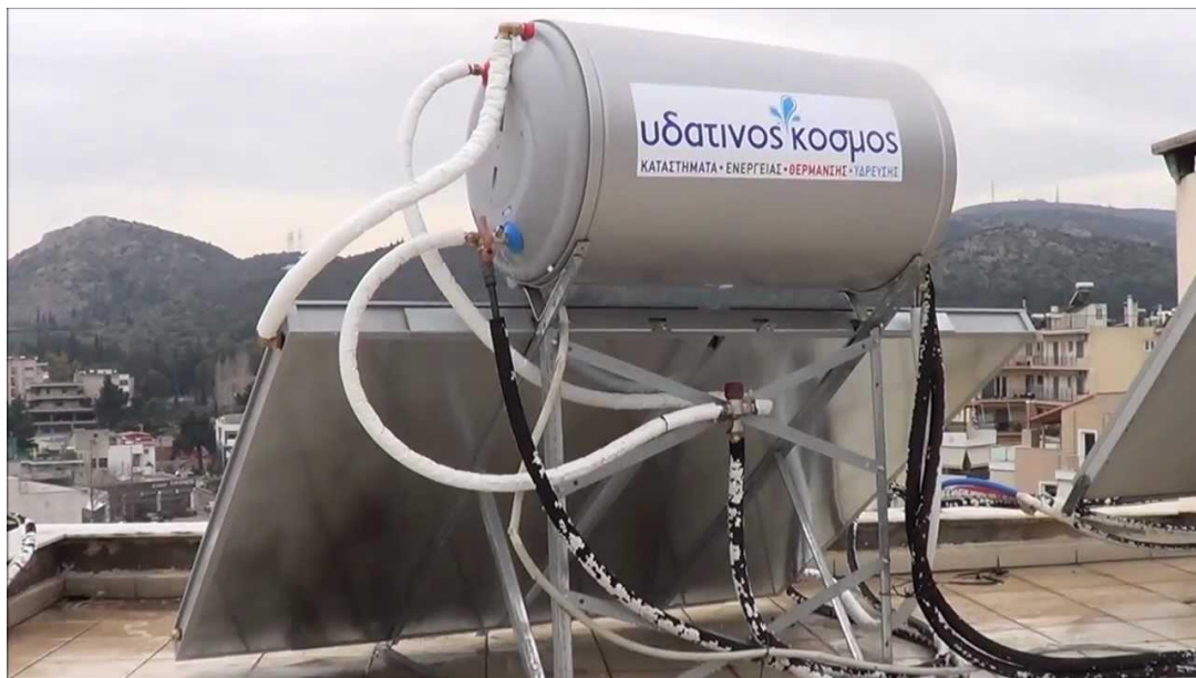
Εικόνα 8 Εγκατεστημένος ηλιακός θερμοσίφοντας
