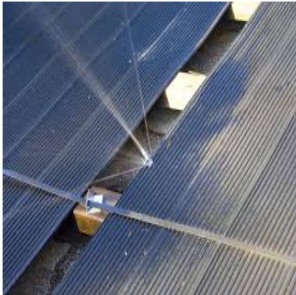
Εικόνα 47 Ρωγμή σε σωληνώσεις θερμοσίφωνα λόγω υψηλής θερμοκρασίας cxix
