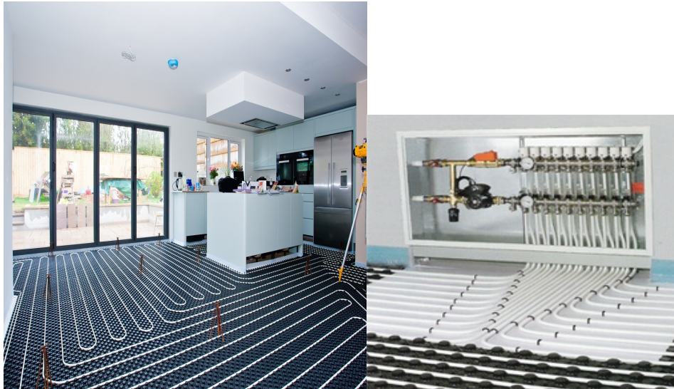
Εικόνα 30: Ενδοδαπέδια θέρμανση civcv
