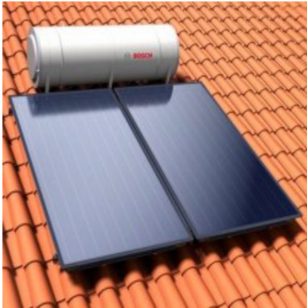
Εικόνα 3: Ηλιακό θερμοσίφωνο, τοποθετημένο πάνω σε σκεπή
