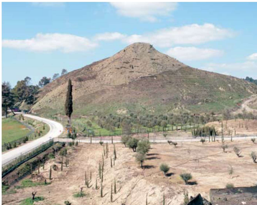
Σχήμα 25. Η ανατολική πλευρά του Κρόνιου λόφου με εμφανή τα αντιδιαβρωτικά έργα και την εγκατάσταση του γεωϋφάσματος στα επικλινή πρανή και την κορυφή. Στο πρώτο επίπεδο διακρίνονται οι φυτεύσεις ελαιοδένδρων και κυπαρισσιών (16-3-2008).
