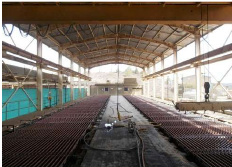
Σχήμα 4.15: Τα κελιά ηλεκτρόλυσης (Υπηρεσία Μεταλλείων του Υπουργείου Γεωργίας)
