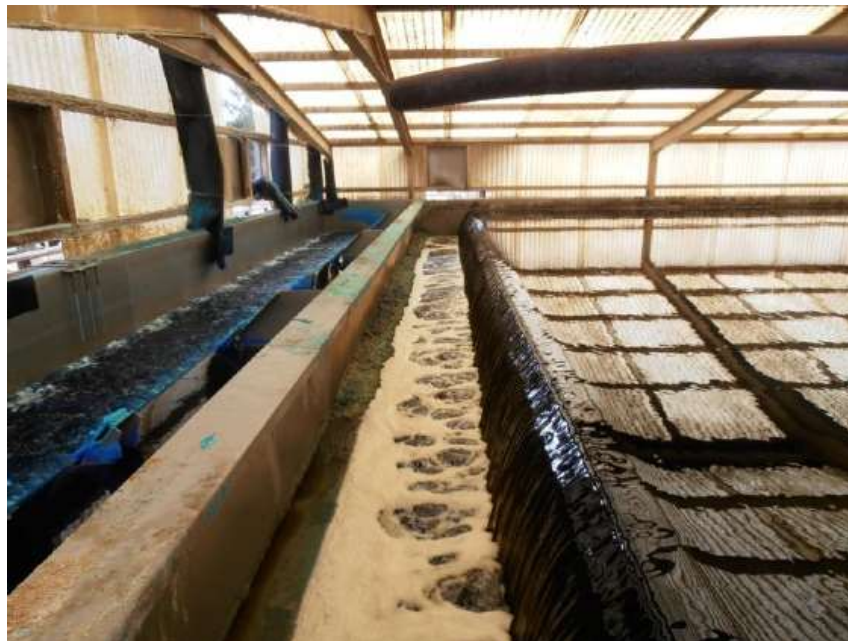
Σχήμα 4.14: Ο τρίτος αναμικτήρας που εμπλουτίζει τον ηλεκτρολύτη με τα ιόντα χαλκού (Υπηρεσία Μεταλλείων του Υπουργείου Γεωργίας)
