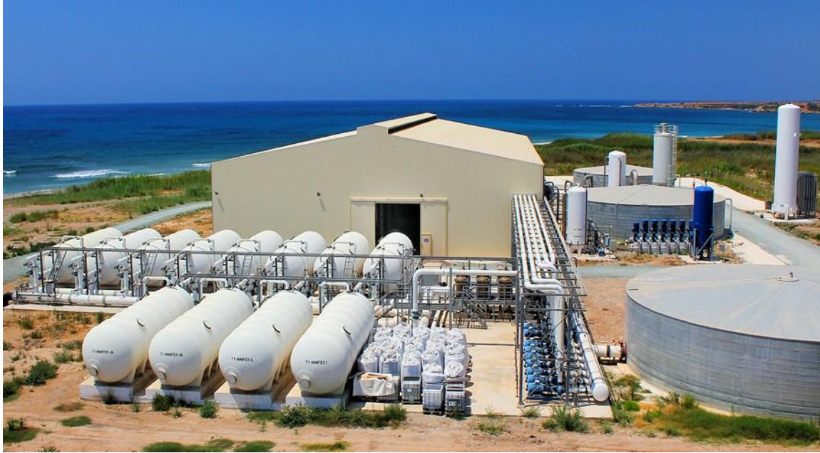
Εικόνα 8. Μονάδα Αντίστροφης Όσμωσης στην Πάφο
