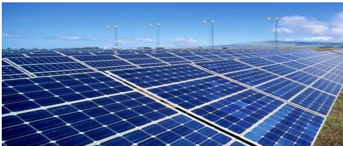
Εικόνα 3 Μονάδα Αφαλάτωσης με Συνδυασμό Φωτοβολταικών
