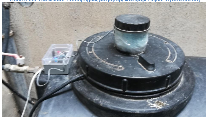
Εικόνα 59: Ultrasonic Αισθητήρας μέτρησης Στάθμης Νερού Τοποθετημένος
