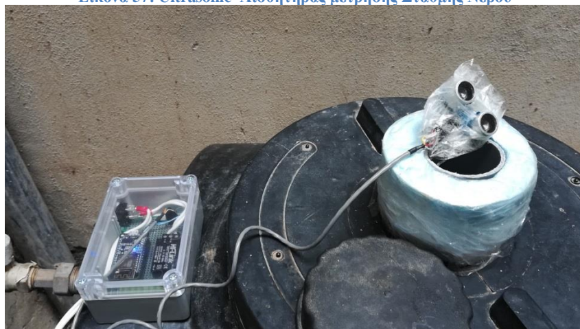
Εικόνα 58: Ultrasonic Αισθητήρας μέτρησης Στάθμης Νερού Εγκατάσταση
