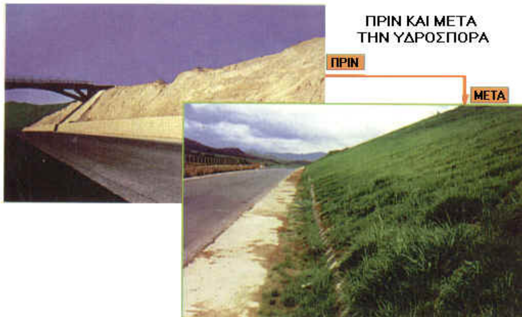
Εικόνα 5.12: Εμφάνιση πρανούς πριν και μετά την υδροσπορά.
