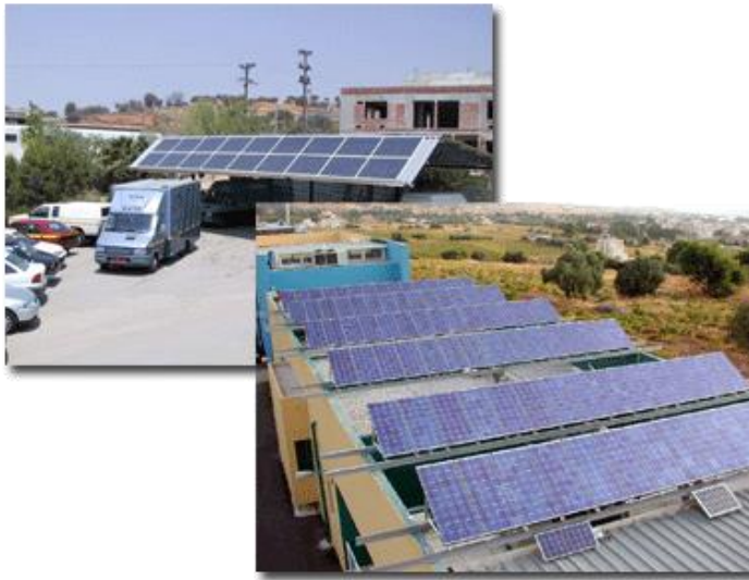
Εικόνα Νο.1 – Φωτοβολταϊκά Πάνελ
