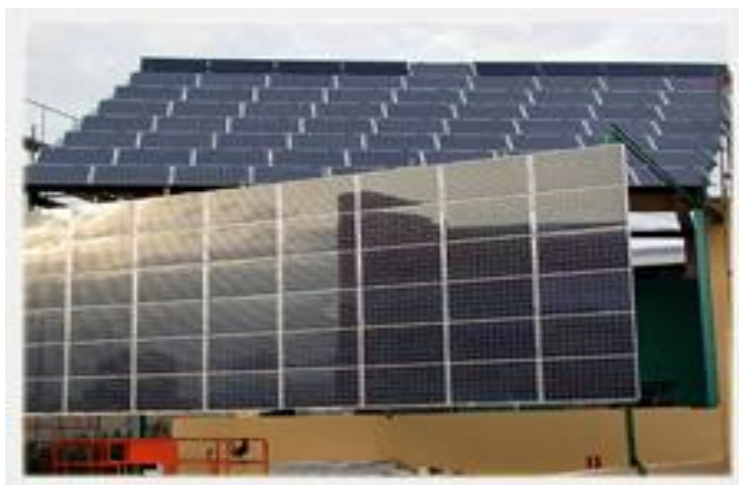
Εικόνα Νο.2 – Φωτοβολταϊκά Πάνελ
