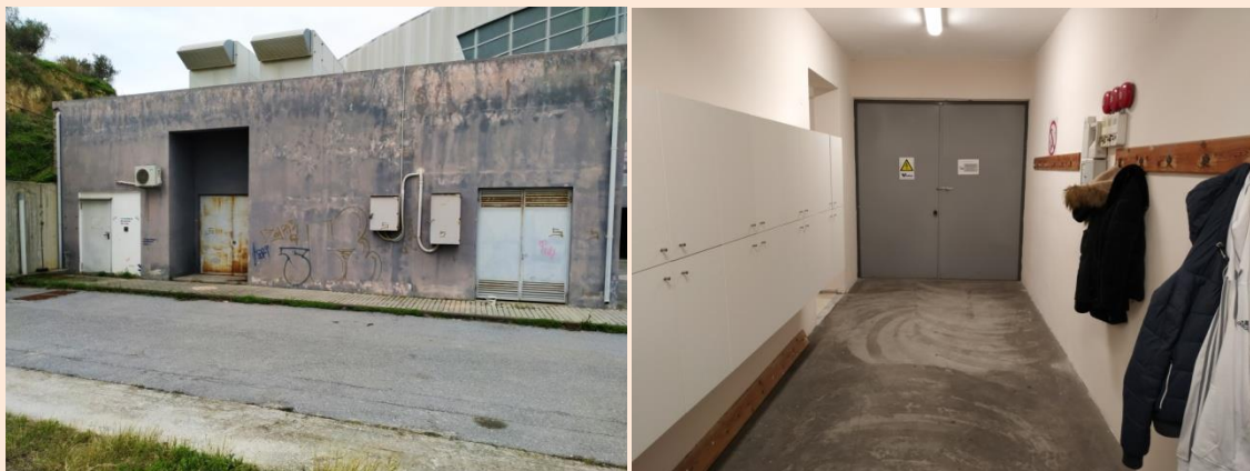
Εικόνα 13: Ηλεκτρολογικές εγκαταστάσεις, Λεβητοστάσιο, Θάλαμος ΟΤΕ
