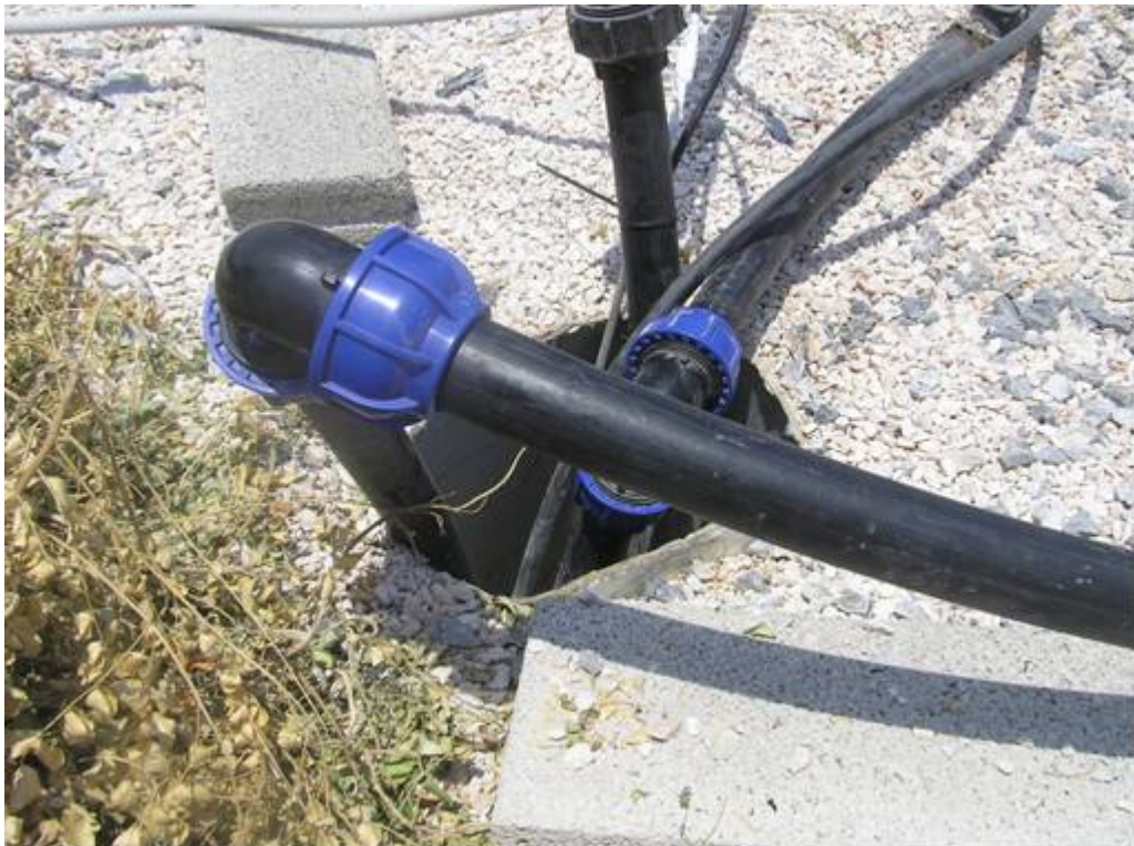
Εικόνα 2. Σύστημα αντλιών στην δεξαμενή απορροής.
