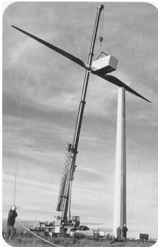
ΣΧΗΜΑ 2.6 Εγκατάσταση ανεμογεννητριών.
