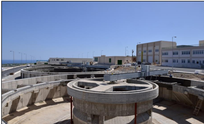
Εικόνα 8: Η Μονάδα Επεξεργασίας Νερού του Αποσελέμη
