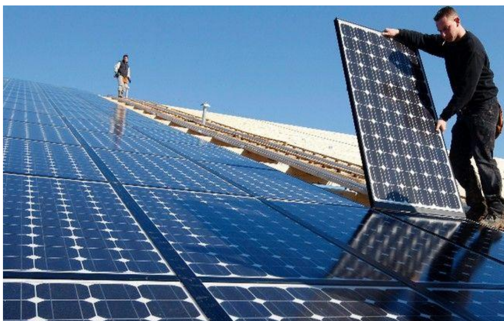
Εικόνα 9. φωτοβολταϊκά σε στέγη
