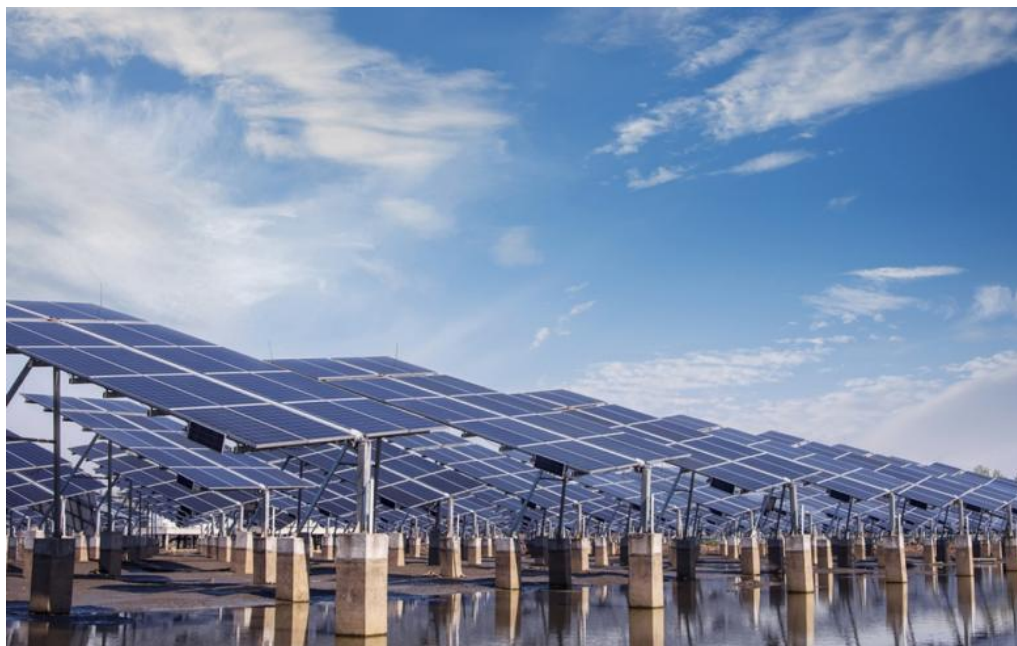
Εικόνα 5. Φωτοβολταϊκό πάρκο στη Κύπρο
