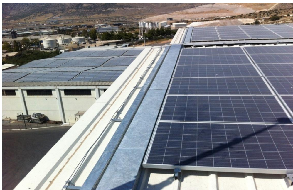
Εικόνα 30. Κτίρια με φωτοβολταϊκά.
