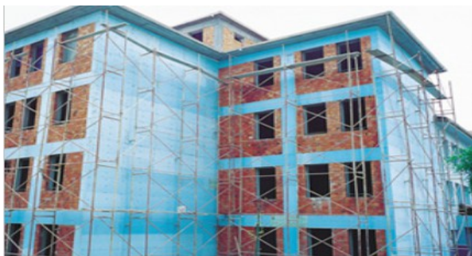
Εικ. 3.5 Εξωτερική θερμομόνωση σε κτίριο Πηγή: www.monoseis-online.gr
