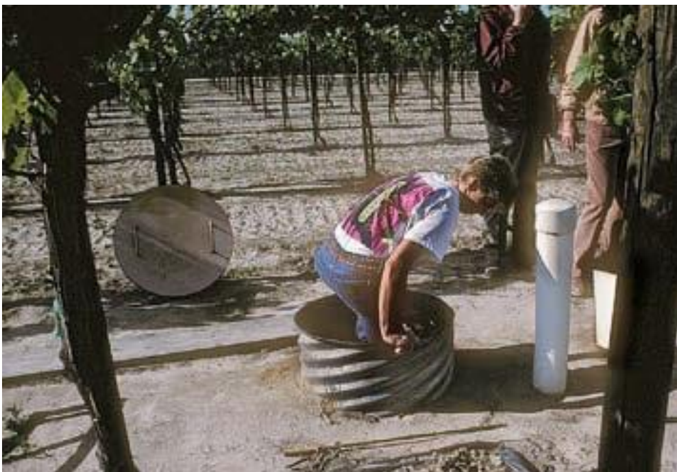
Εικόνα 14. Τελική μορφή εγκατεστημένου Λυσίμετρου (Είσοδος Επιστημονικού Προσωπικού στο εσωτερικό του Λυσίμετρου από ειδικό αγωγό) Πηγή: Johnson et al. (2005)
