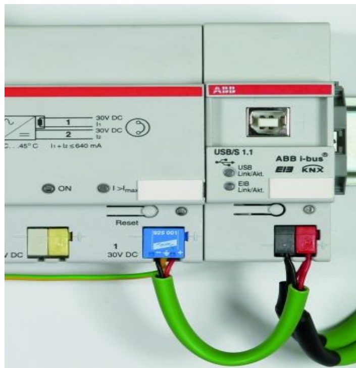
Εικόνα 111. Τοποθέτηση κλέμματος υπερτάσεων σε τροφοδοτικό 47
