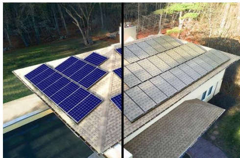
Εικόνα 34: Φωτοβολταϊκή τεχνολογία ηλιακών δερμάτων εγκατεστημένα σε ταράτσα ενός σπιτιού
