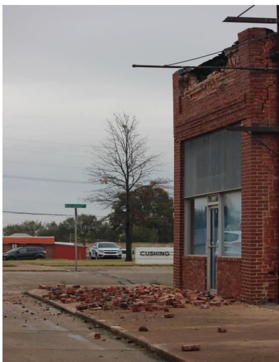
Εικόνα 16 Καταστροφή σε κτίρια στο Κιουίνγκ της Οκλαχόμα από τον σεισμό μεγέθους 5,0 στις 6 Νοεμβρίου 2016. Τα μη ενισχυμένα κτίρια και οι προσόψεις από τούβλα και πέτρινες τοιχοποιίες είναι ευάλωτα σε έντονες δονήσεις. Φωτογραφία από: Dolan Paris, USGS
