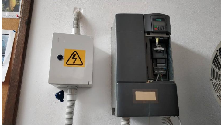
Εικόνα 21. Δεξιά είναι ο inverter και αριστερά ο γενικός διακόπτης
