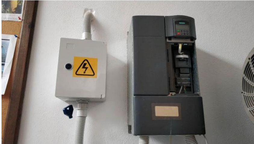
Εικόνα 37. Ο inverter μαζί με τον γενικό διακόπτη
