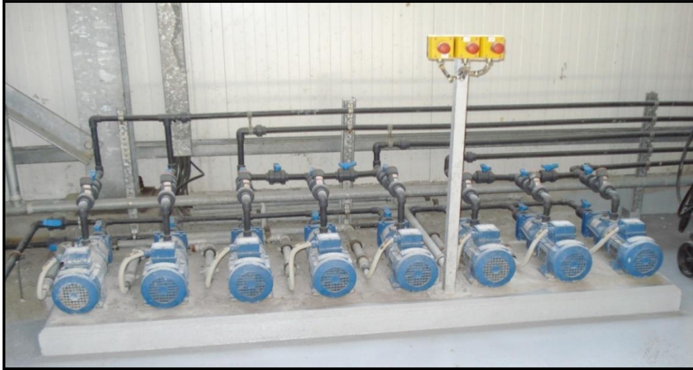
+++++++ Αντλίες για πολυηλεκτρολήτη, νέας και παλαιάς μονάδας αφυδάτωσης ΜΕΛ Ηρακλείου
