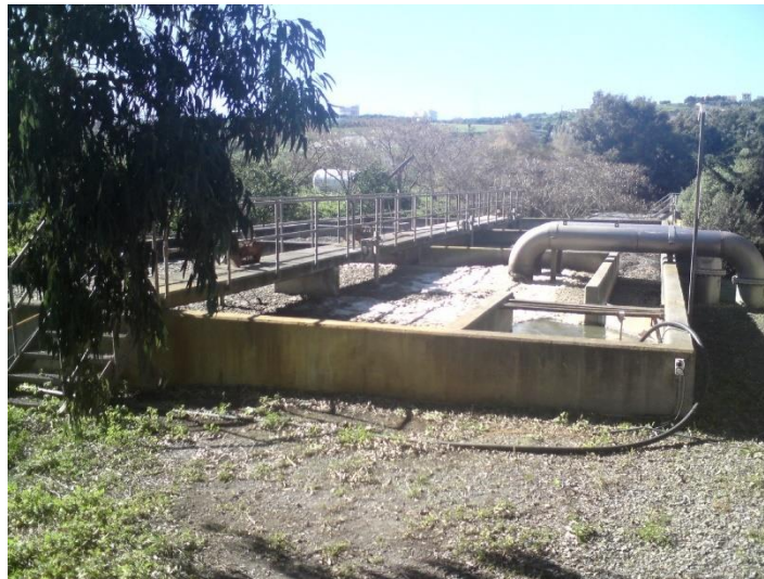
Εικόνα 23 Δεξαμενές επιλογής ΜΕΛ Ηρακλείου
