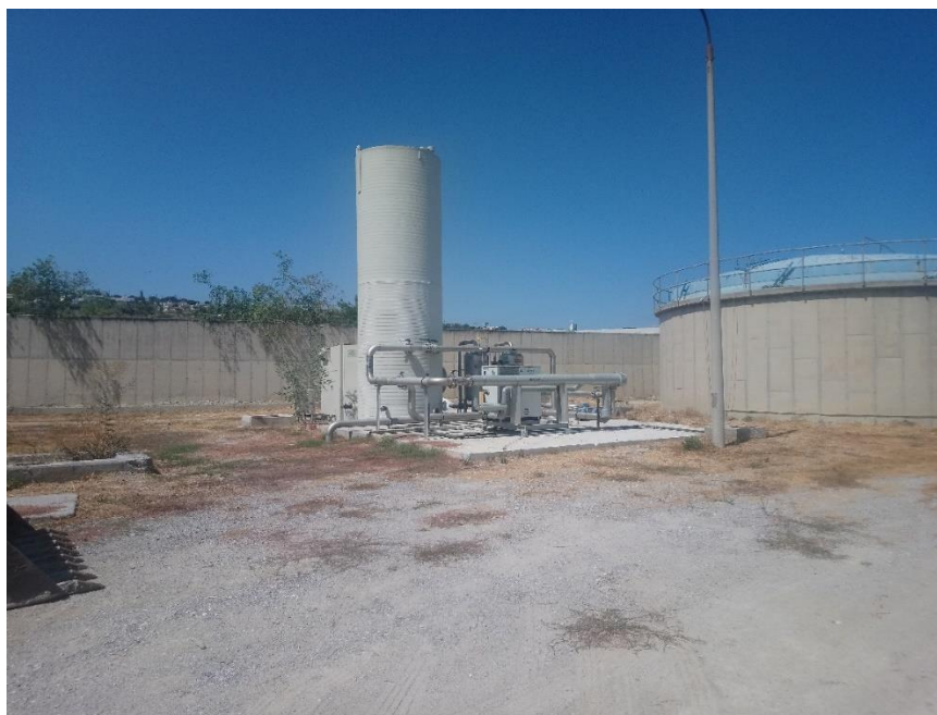
Εικόνα 39 Μονάδα αποθείωσης ΜΕΛ Ηρακλείου
