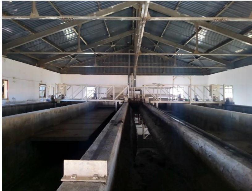
Εικόνα 18 Αυτοκινούμενες γέφυρες μονάδας εξαμμωσης –απολίπανσης ΜΕΛ Ηρακλείου
