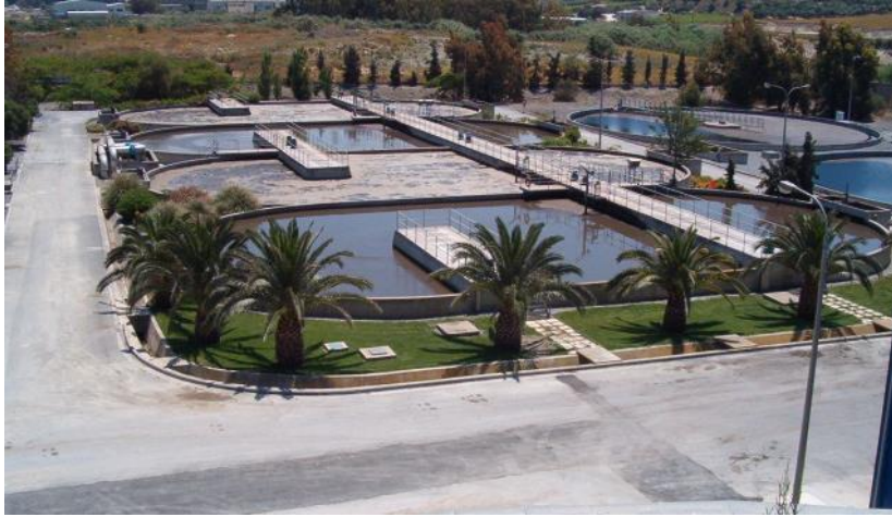
Εικόνα 24 Δεξαμενές αερισμού ΜΕΛ Ηρακλείου
