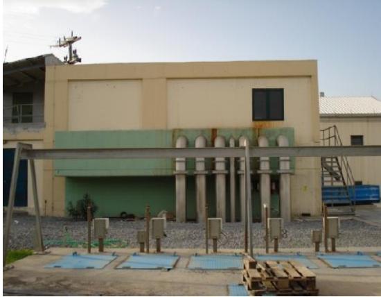
Εικόνα 14 Αντλιοστάσιο αρχικής ανύψωσης Πηγή: ΔΕΥΑΗ
