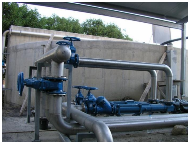
Εικόνα 34 Αντλίες τροφοδοσίας ιλύος νέας μονάδας αφυδάτωσης ΜΕΛ Ηρακλείου
