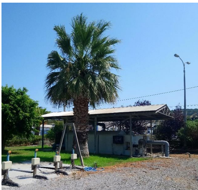
Εικόνα 44 Μονάδα απόσμησης ΜΕΛ Ηρακλείου
