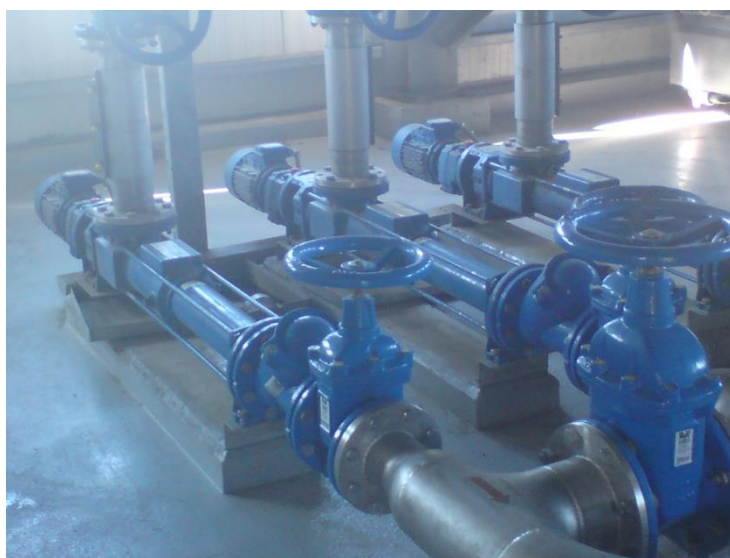
Εικόνα 36 Αντλίες απομάκρυνσης ιλύος μονάδας μηχανικής πάχυνσης
