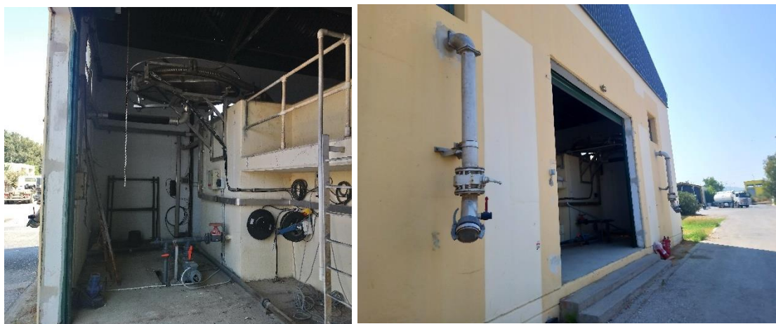
Εικόνα 20 Σύστημα απομάκρυνσης λιπών μονάδας εξάμμωσης – απολίπανσης ΜΕΛ Ηρακλείου
