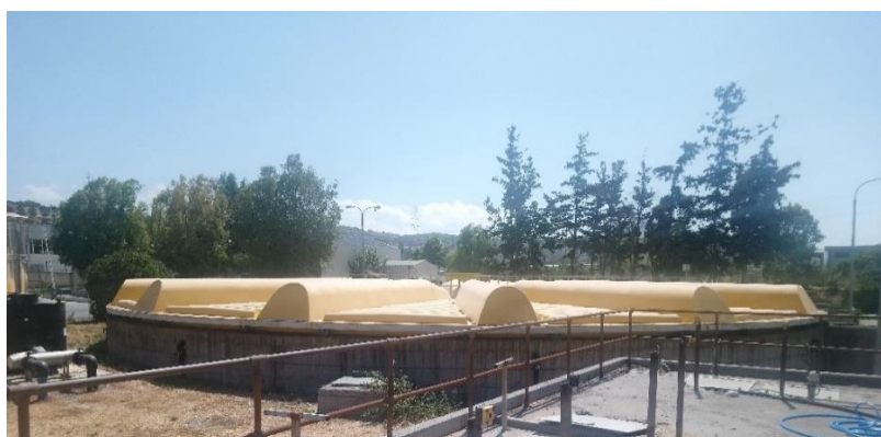
Εικόνα 22 Κάλυμμα καναλιού υπερχειλίσης πρωτοβάθμιας καθίζησης ΜΕΛ Ηρακλείου
