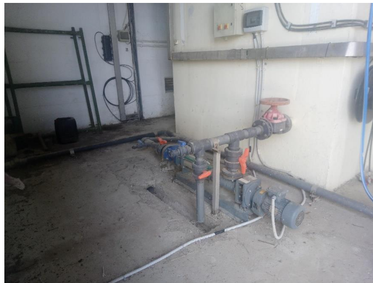
Εικόνα 19 Αντλίες απομάκρυνσης λιπών μονάδας εξαμμωσης – απολιπαντές ΜΕΛ Ηρακλείου.
