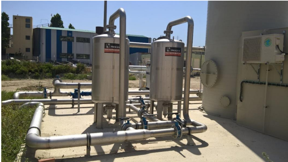
Εικόνα 41 Μονάδα καθαρισμού με ενεργό άνθρακα (Πηγή: ΔΕΥΑΗ)
