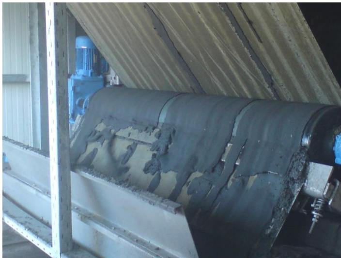
Εικόνα 32 Αφυδατωμένη ιλύς νέας ταινιοφιλτρόπρεσσα ΜΕΛ Ηρακλείου
