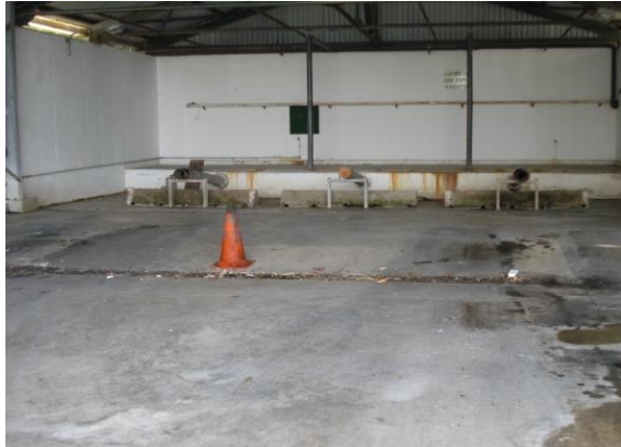
Εικόνα 15 Μονάδα υποδοχής βοθρολυμάτων ΜΕΛ Ηρακλείου πηγή ΔΕΥΑΗ
