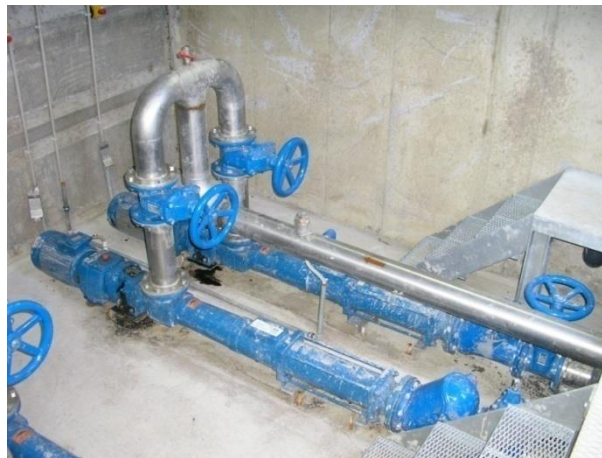
Εικόνα 28 Αντλίες πρωτοβάθμιας λάσπης ΜΕΛ Ηρακλείου
