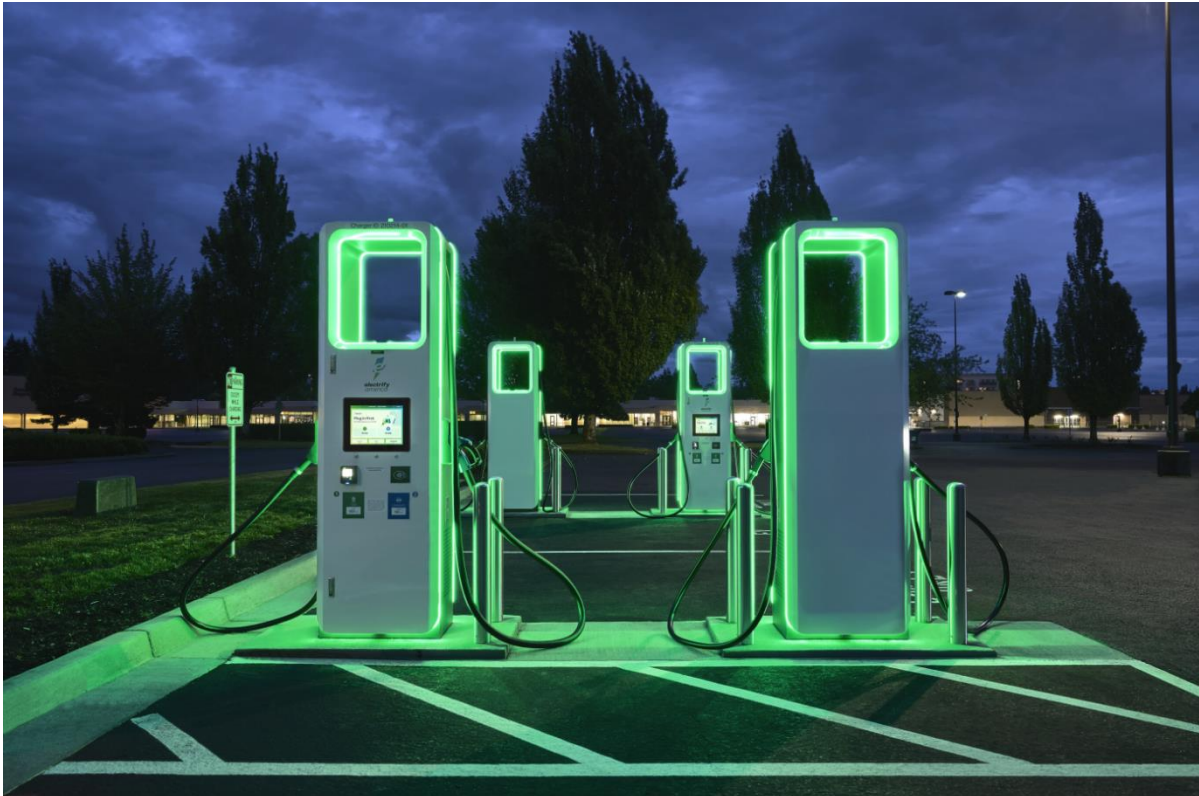
Εικόνα 12: Τυπικός σταθμός φόρτισης εξωτερικού χώρου EV
