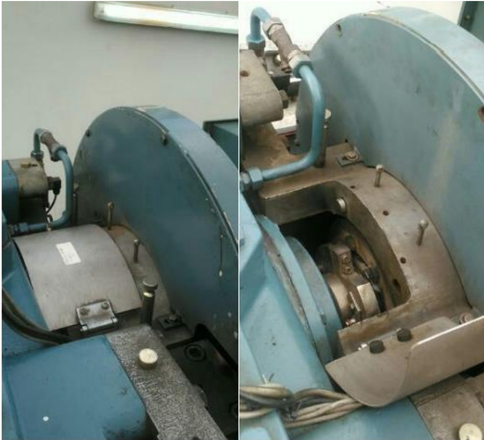
Εικόνα 3.5 Ασφάλεια δρομέα του Gearbox με κλειστό/ανοιχτό καπάκι.
