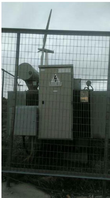
Εικόνα 6.7 Μετασχηματιστής Α/Γ με προειδοποιητική σήμανση.
