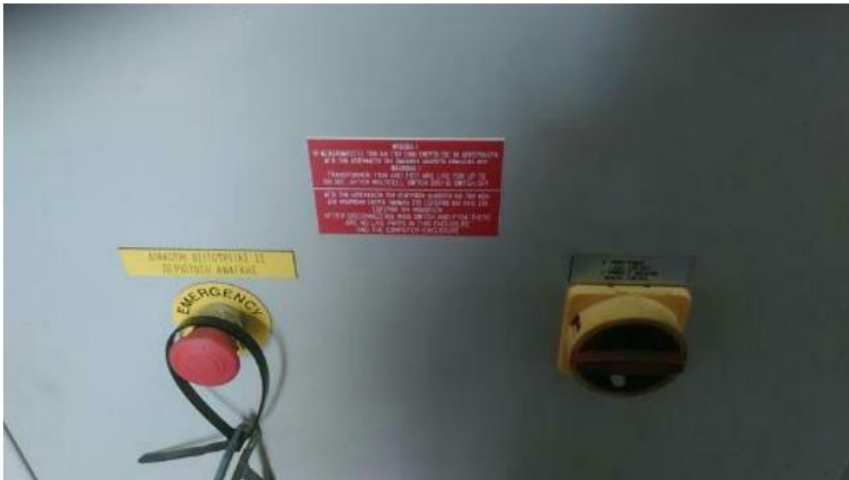
Εικόνα 3.1 Διακόπτης ασφαλείας στο πίνακα Α1 της βάσης του πύργου της Α/Γ.
