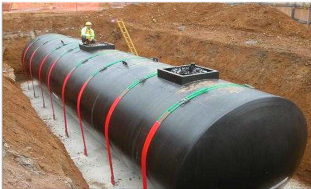
Εικόνα 3 Υπόγεια δεξαμενή υγρών καυσίμων δύο (2) διαμερισμάτων [google.com]
