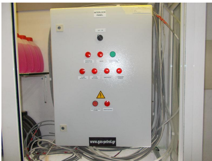
Εικόνα 24 Πίνακας Interlock (panel) εσωτερικά του πρατηρίου καυσίμων [Falcon Hellas]
