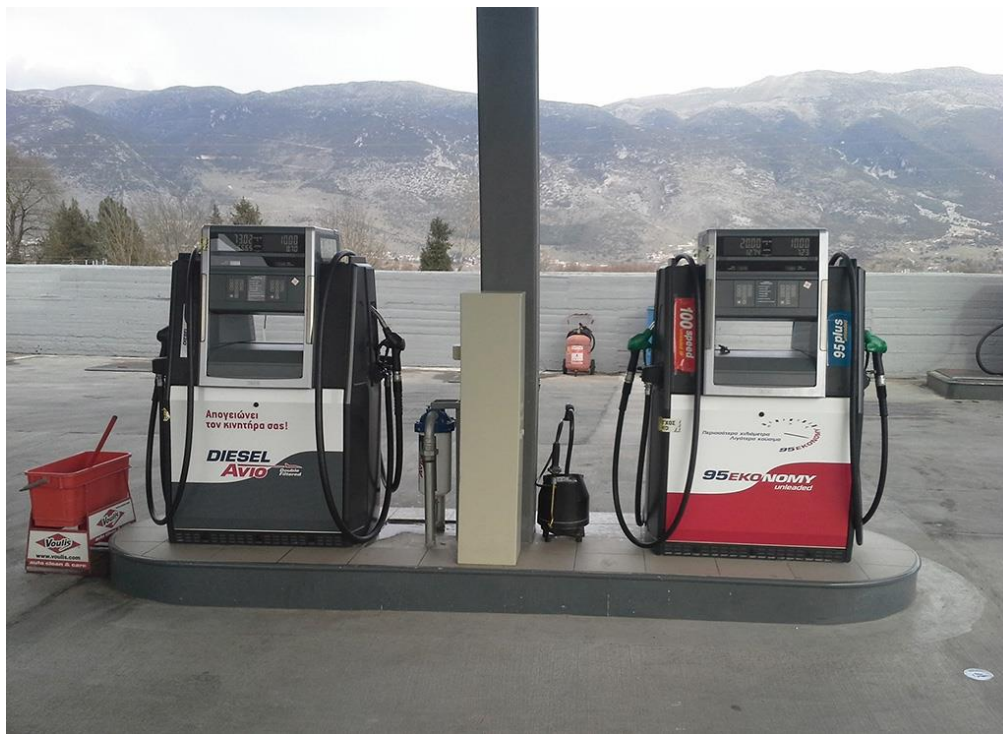
Εικόνα 4 Αντλίες Υγρών Καυσίμων δύο (2) επιστομιών
