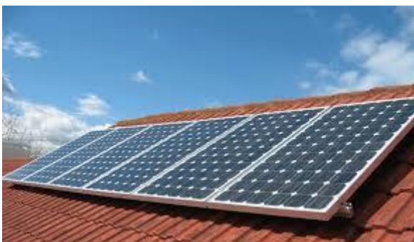
Εικόνα 1.1.1 Φωτοβολταϊκά σε στέγη
