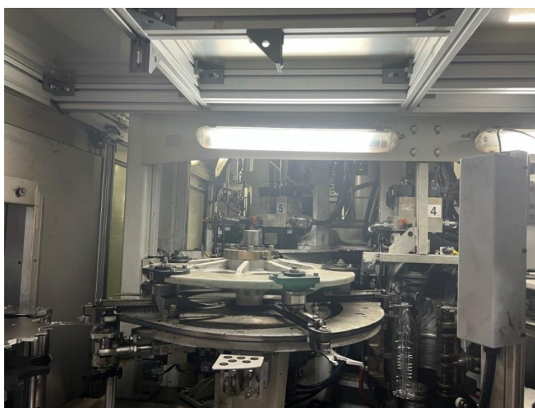
Εικόνα 15. Τροχός μεταφοράς από τον κλίβανο στον τροχό εμφύσησης
