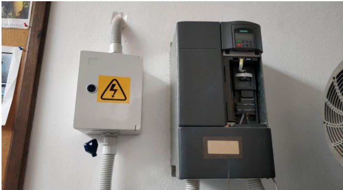
Εικόνα 19: Ο inverter μαζί με τον γενικό διακόπτη.
