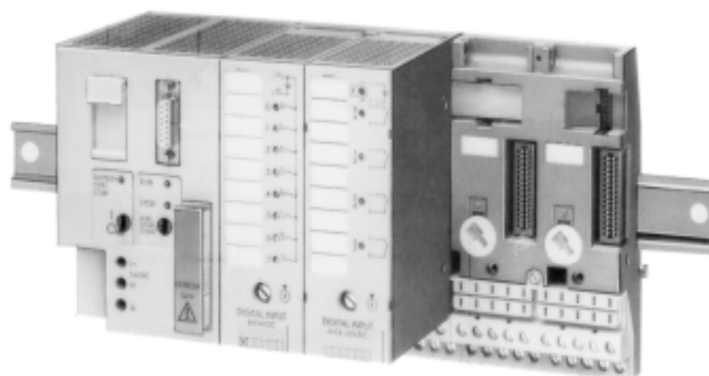
Εικόνα 23: Κεντρική μονάδα επεξεργασίας και μονάδες εισόδων ενός PLC
