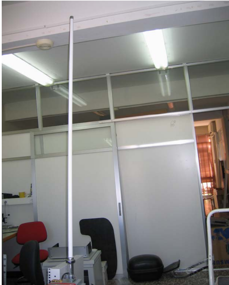
Εικόνα 1.3: Κεραία Access Point κινητής μονάδας
