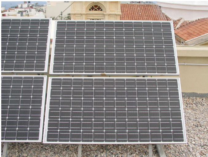
(σχήμα 49) Φ/Β πάνελ Shell Solar SM-100 τοποθετημένα ανά ζεύγος επάνω σε μεταλλική βάση.
