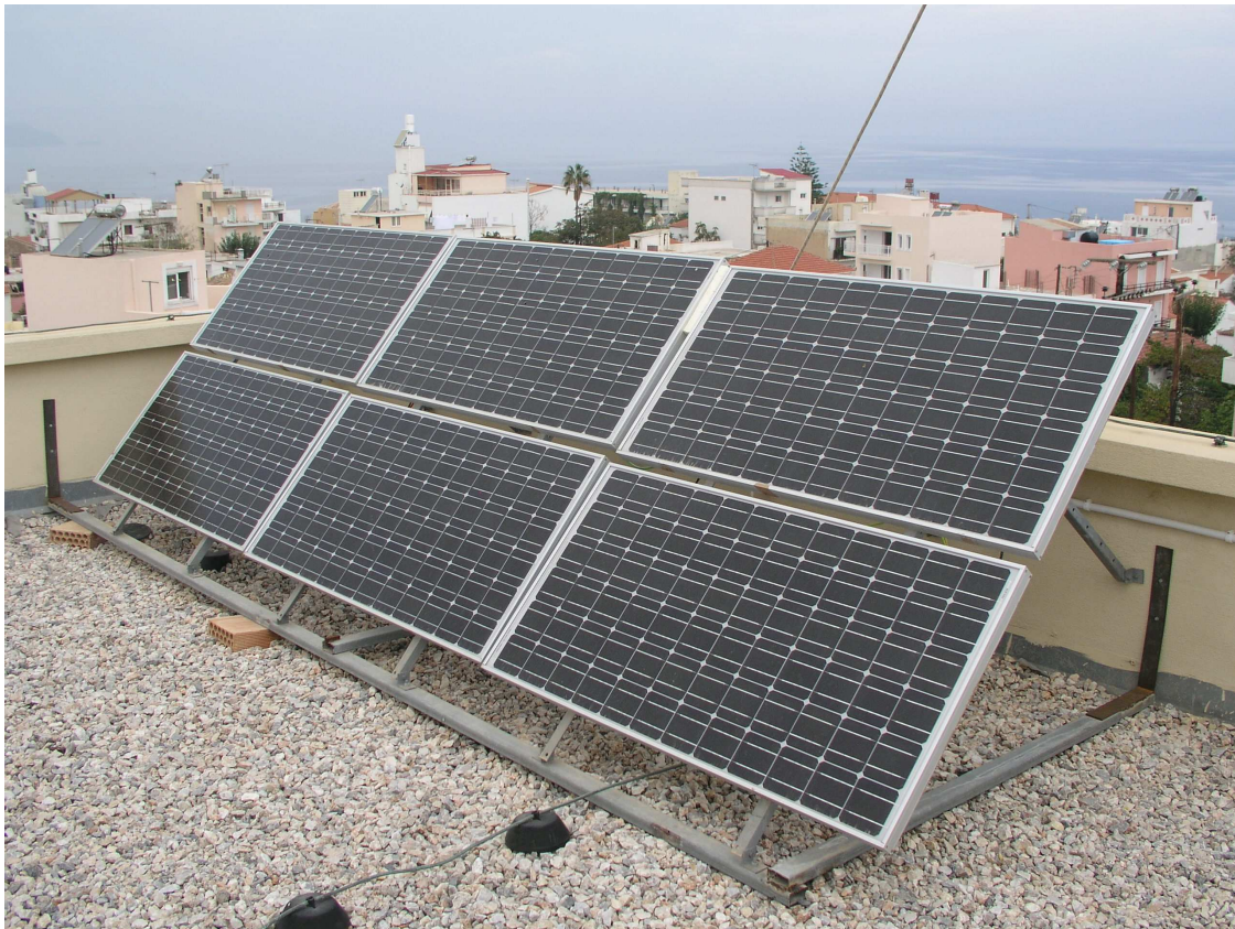
(σχήμα 57) Ολοκληρωμένη Φ/Β εγκατάσταση.
