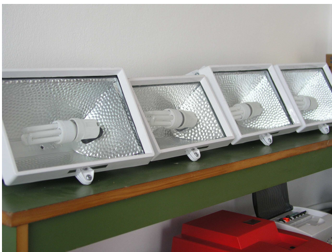
(σχήμα 65) Προβολείς με λαμπτήρες 15W για τον φωτισμό του εργαστηρίου
