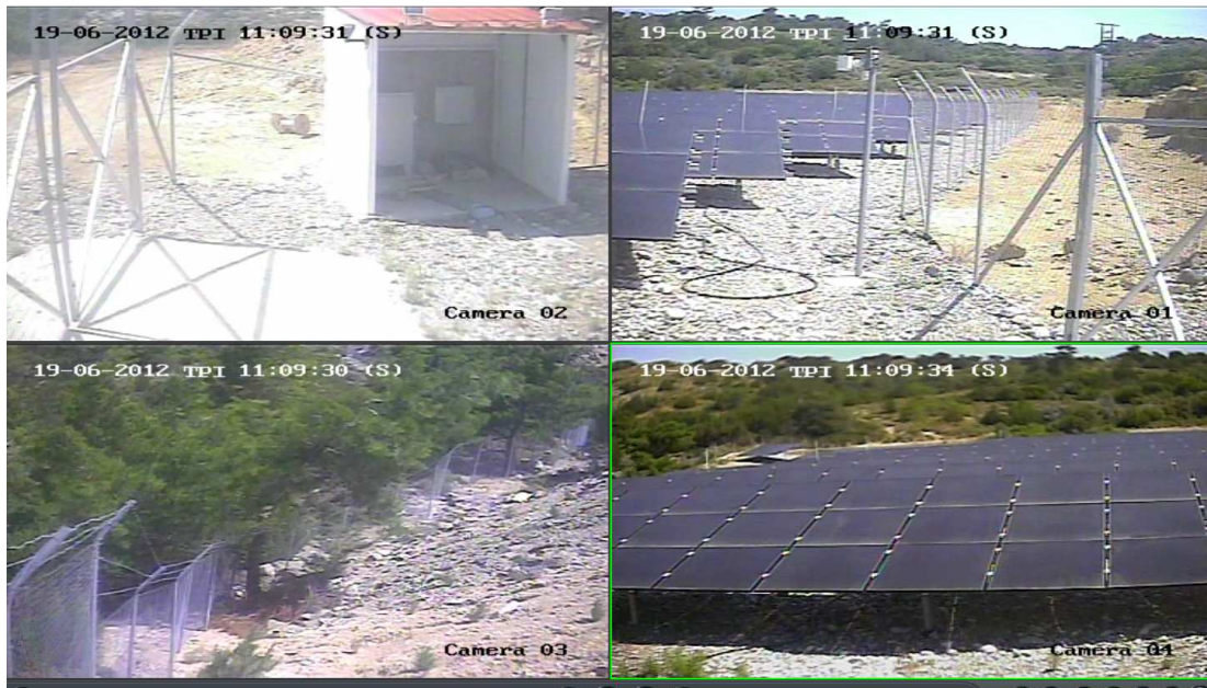
Παρακολούθηση Φωτοβολταϊκού Πάρκου
