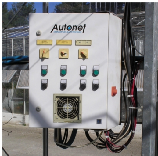
Εικόνα 3.8 Ο πίνακας ελέγχου του υπάρχοντος συστήματος ελέγχου
