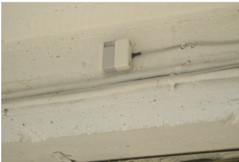
Εικόνα 3.4 Το αισθητήριο εγκατεστημένο στον εξωτερικό χώρο, για την μέτρηση της εξωτερικής θερμοκρασίας
