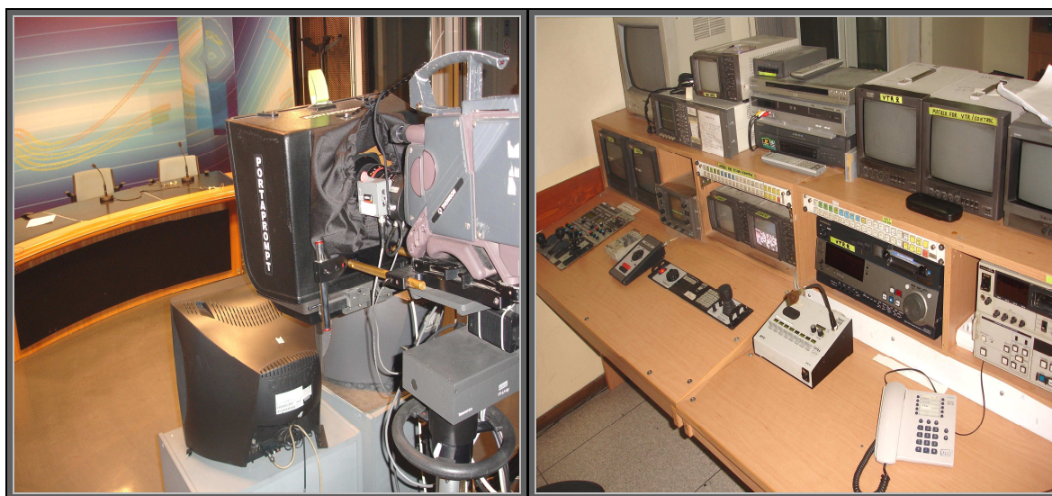
Σχήμα 5.3.1 Εικόνα από το STUDIO της NET και από το CONTROL ROOM στο οποίο διακρίνονται αριστερά οι μονάδες των CCU .
