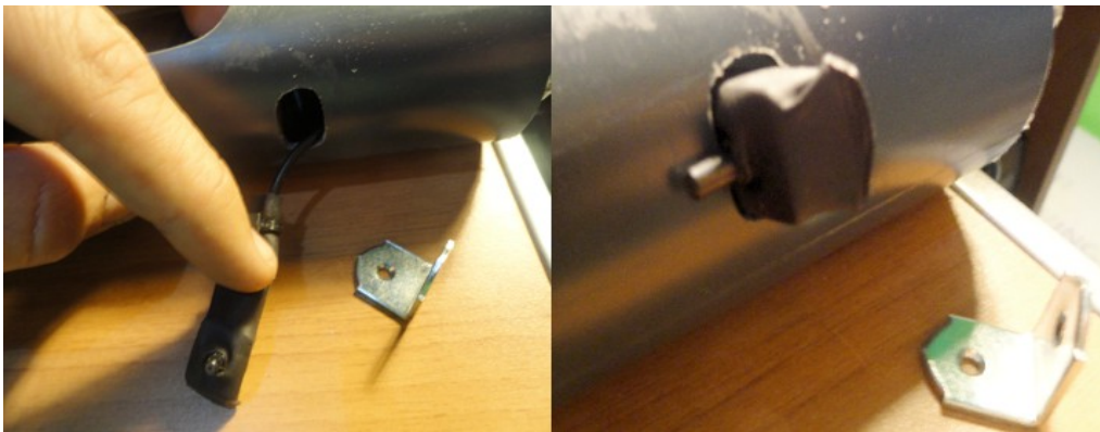
Εικόνα 38: Τοποθέτηση του αισθητήρα αέρα.
