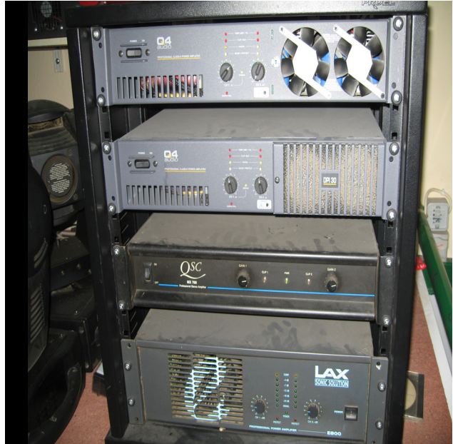
Ενισχυτές ηλεκτροακουστικής εγκατάστασης
