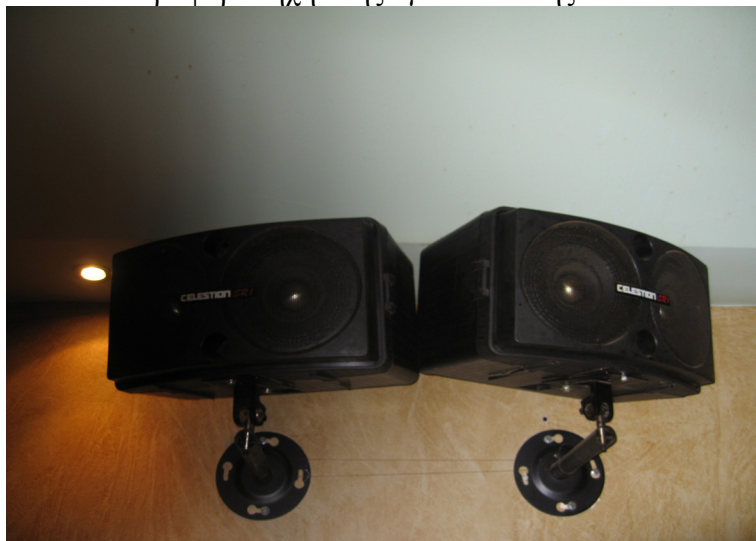
Εικόνα 4: Δορυφόροι ηχητικής εγκατάστασης
