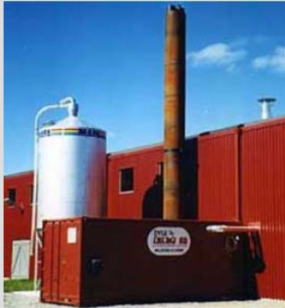
Εικόνα 2.7 Αποθηκευτικός χώρος pellets (σιλό)
