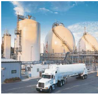
Σχήμα 4.1 Δεξαμενή αποθήκευσης αέριου υδρογόνου Σε χαμηλή πίεση
