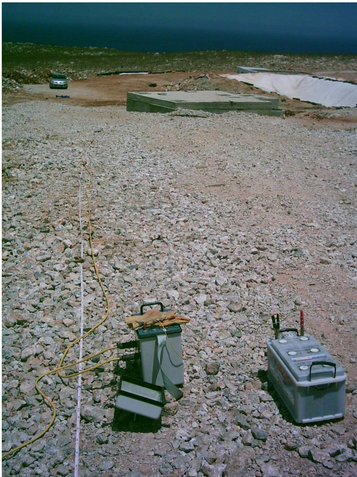
Σχήμα 71. Το καταγραφικό σύστημα που χρησιμοποιήθηκε κατά την εκτέλεση των μετρήσεων και η επιφάνεια της υπόγειας δεξαμενής. Εδώ διακρίνουμε καλύτερα τα «σκληρά» πετρώματα που υπάρχουν σ' αυτό το σημείο του εργοτάξιου.
