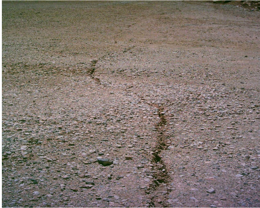
Σχήμα 82. Παρουσία ρωγμών στο δρόμο που υπάρχει μέσα στο εργοτάξιο αλλά και σε όλο το χώρο γενικότερα.
