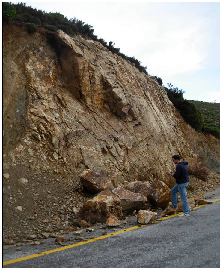
Εικόνα 5: Κατολίσθηση στο Ν. Χανίων (περιοχή Πέτρας Σελί).
