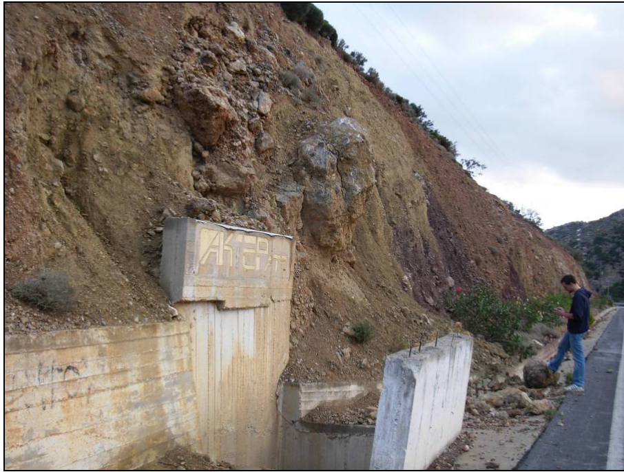
Εικόνα 46: Κατολίσθηση στο οδικό δίκτυο Παλαιόχωρα – Κάνδανος.
