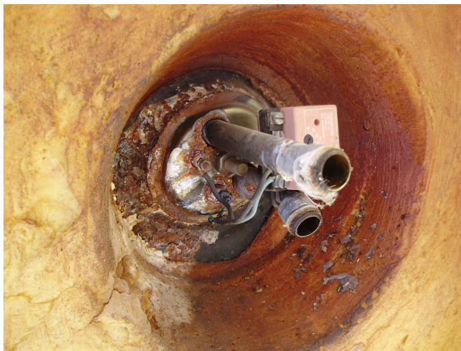
Εικόνα 3.1 Το αποτέλεσμα μη συντήρησης της δεξαμενής αποθήκευσης(μπόιλερ) και μη αλλαγής του ανόδιου μαγνησίου.
