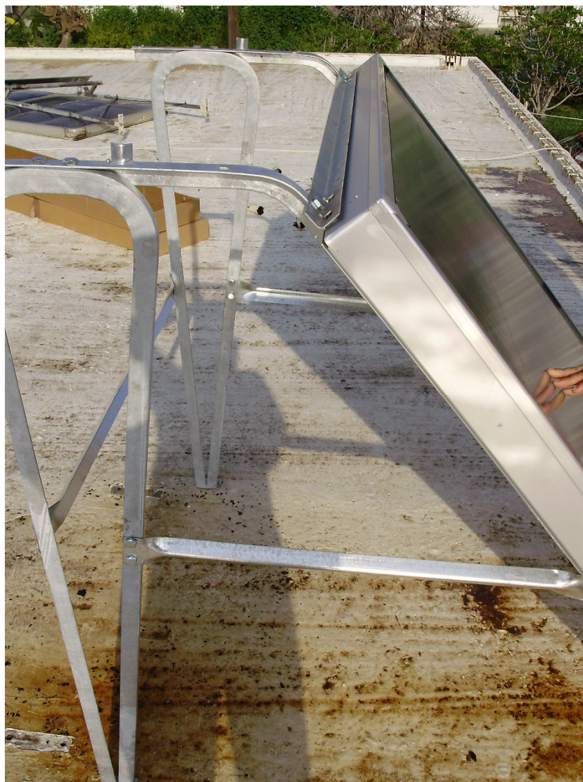
Εικόνα 4.24 Η θέση που τοποθετείται η δεξαμενή αποθήκευσης(μπόιλερ) .
