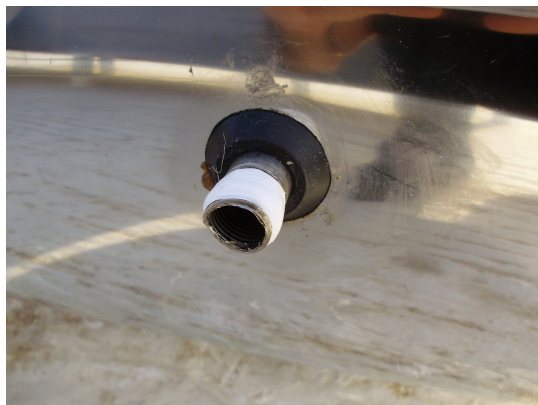
Εικόνα 4.26 Επικάλυψη των σπειρωμάτων του καθρέπτη με κανάβι και τεφλόν τεφλόν (η στεγανοποίηση των σπειρωμάτων μπορεί να γίνει και με υγρό τεφλόν).
