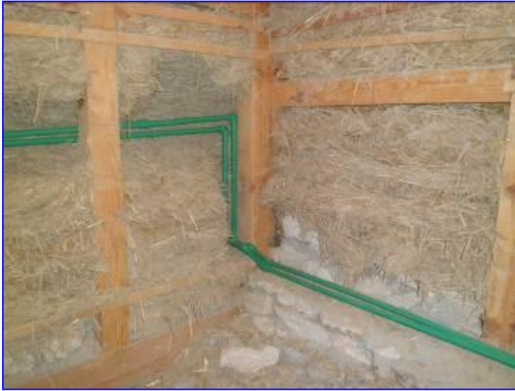
Φωτογραφίες από υδραυλική εγκατάσταση
