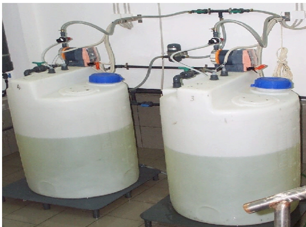
Εικόνα 14. Συγκρότημα Μεταχλωρίωσης Δεξ. Βαντέ
