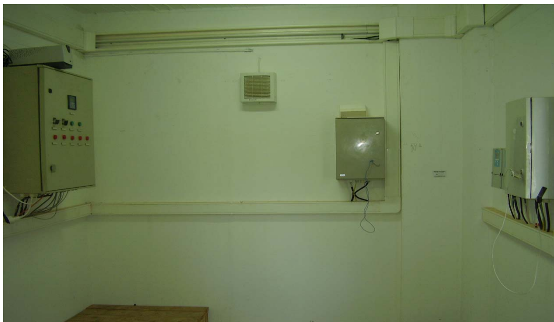
Εικόνα 9. Ηλεκτρικοί Πίνακες Μέτρησης Ελεύθερου Υπολειμματικού Χλωρίου, Παροχής Αγωγών, Θολερότητας, ΡΗ και Αγωγιμότητας
