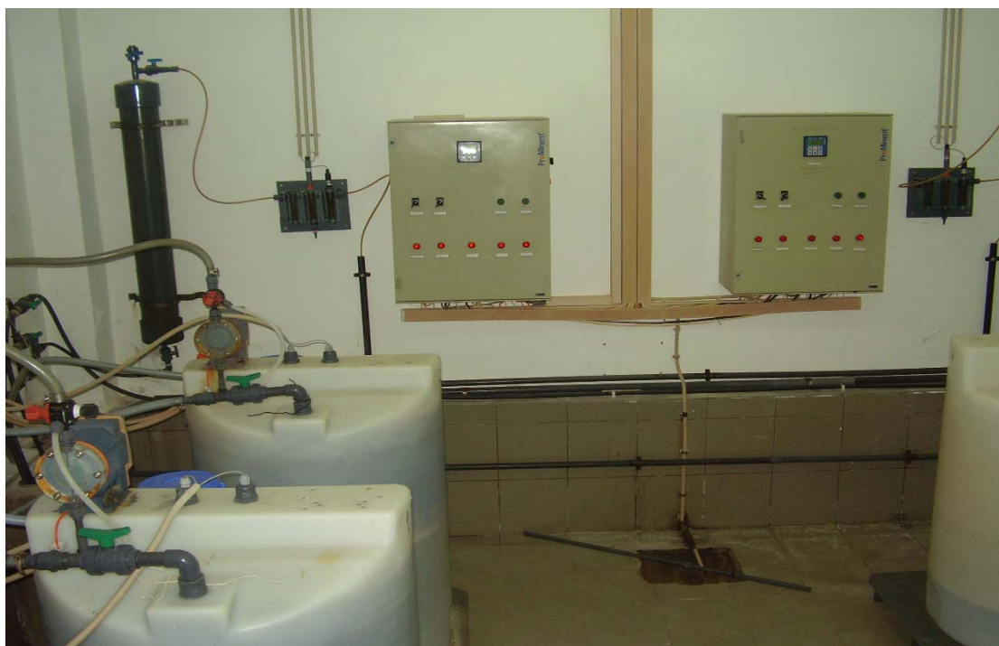
Εικόνα 11. Συγκροτήματα Προχλωρίωσης και Μεταχλωρίωσης Δεξ. Βαντέ
