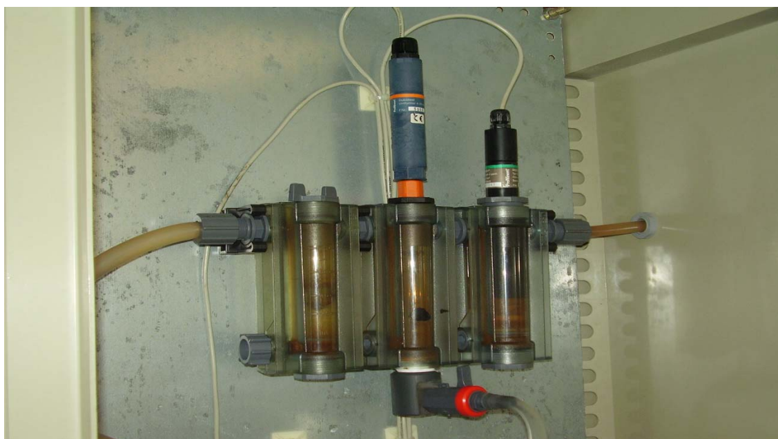
Εικόνα 6.Αισθητήρια Μέτρησης HOCL,PH,T στον Αγωγό Φ350 στην Αγιά.
