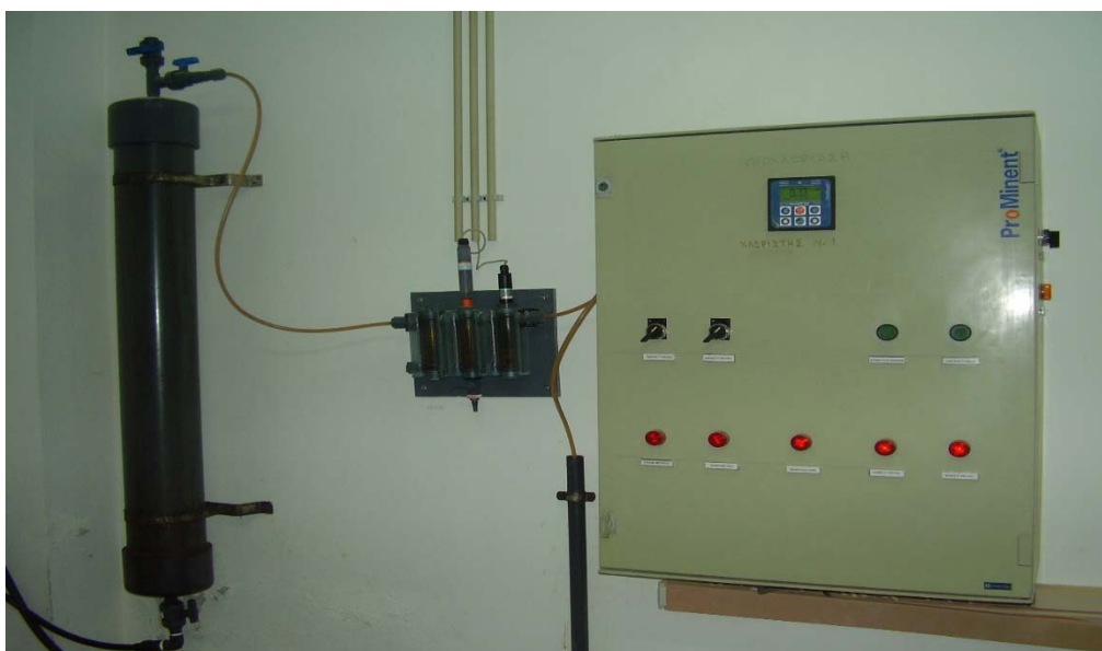
Εικόνα 16. Συγκροτήματα Χλωρίωσης Δεξ. Βαντέ, Σύστημα Δειγματοληψίας και Μέτρησης
