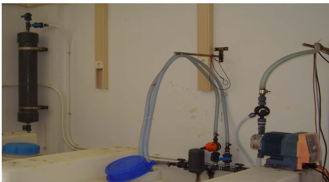
Εικόνα 2.Συγκρότημα Χλωρίωσης Αγωγού Φ350 στην Αγιά
