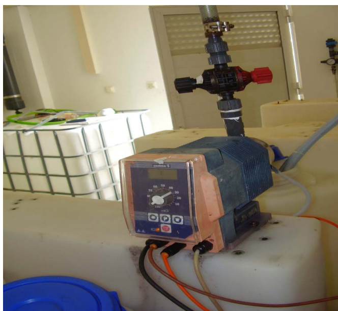
Εικόνα 4. Συγκρότημα Χλωρίωσης Αγωγού Φ350 στην Αγιά, Δοσομετρική Αντλία Χλωρίωσης
