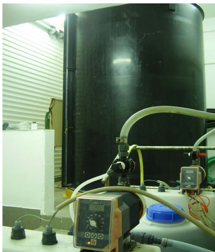
Εικόνα 12. Συγκρότημα Προχλωρίωσης και Κύρια Δεξ. Αποθήκευσης Χλωρίου Δεξ. Βαντέ.
