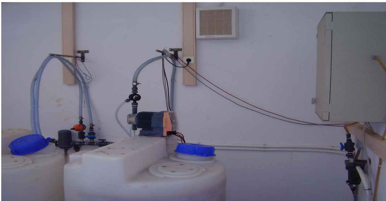
Εικόνα 3. Συγκρότημα Χλωρίωσης Αγωγού Φ350 στην Αγιά
