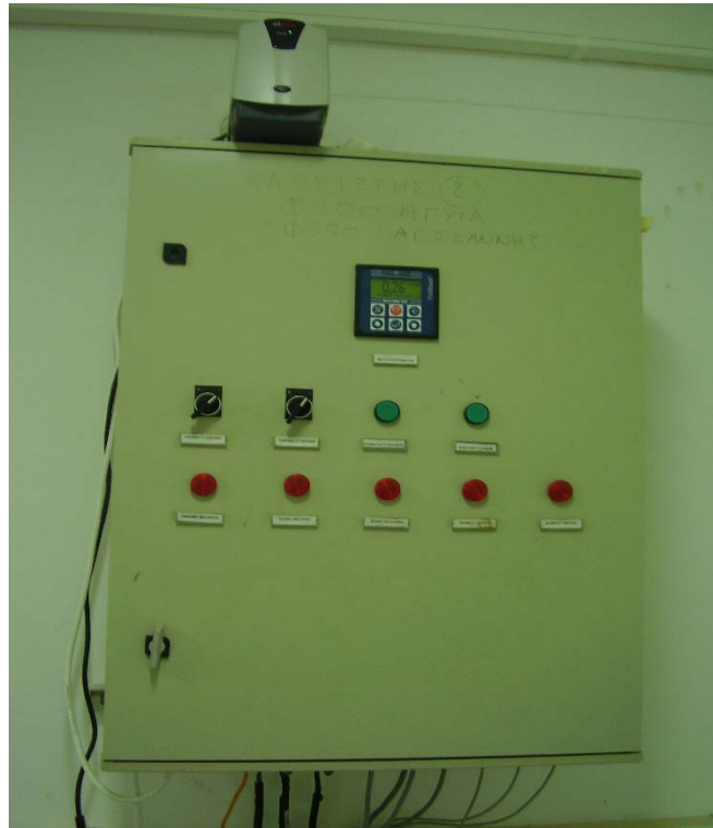
Εικόνα 7. Ηλεκτρικός Πίνακας Μέτρησης Ελεύθερου Υπολειμματικού Χλωρίου και Ελέγχου Αντλιών Χλωρίωσης του Αγωγού Φ350 στην Αγιά.
