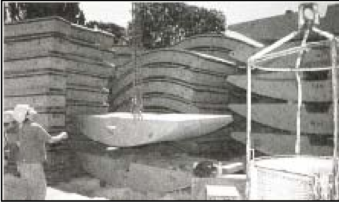
Σχήμα 32β. Προκατασκευασμένοι δακτύλιοι επενδύσεως με περιφερειακό λάστιχο στεγανώσεως. Στη μέση στοιχείο δαπέδου (Αθηναϊκό Μετρό).
