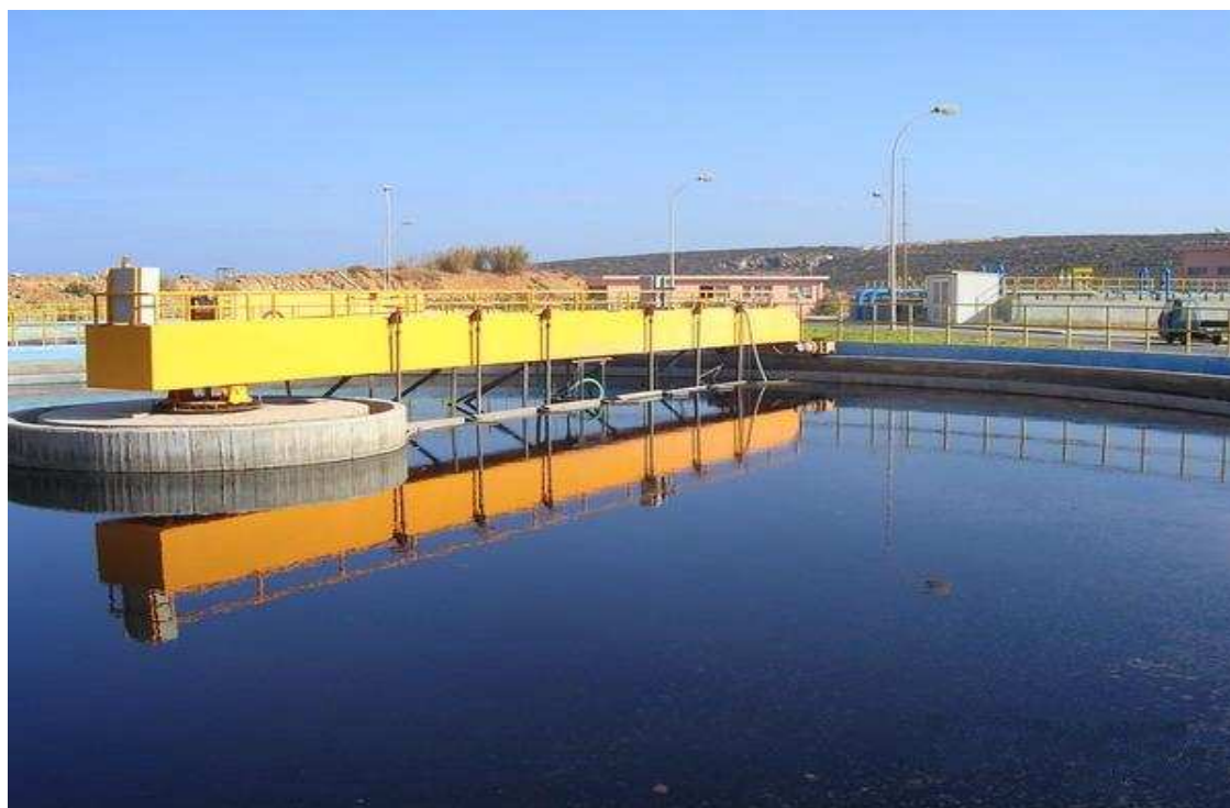
Εικ. 4.1. Δεξαμενή Β Καθίζησης.
