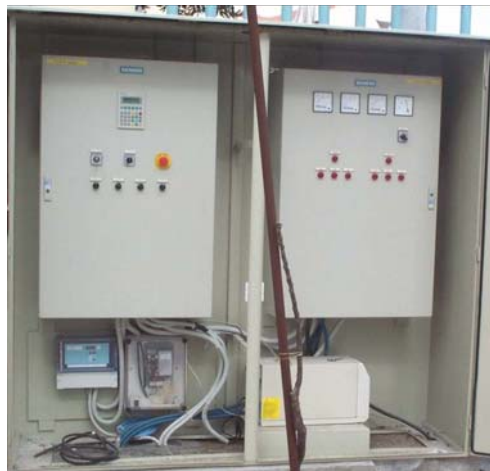
Εικόνα 4.1 Εξωτερικός τοπικός σταθμός. Στην φωτογραφία διακρίνονται οι πίνακες ισχύος, ο πίνακας του μικροελεκτή (PLC) καθώς και η μονάδα παροχής αδιάλειπτης τάσης (UPS) [26]
