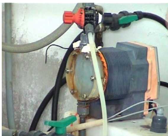
Εικόνα 4.8 Δοσομετρική αντλία χλωρίωσης στον τοπικό σταθμό ΤΣΥ03 στον Βαντέ [27]
