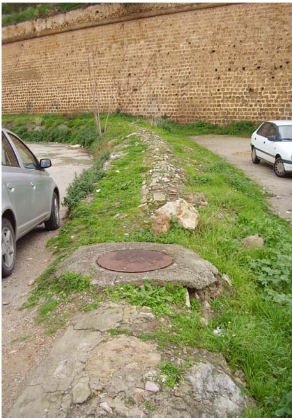
Εικόνα 18 :Το καπάκι του αγωγού στο Parking στην Πύλη της Άμμου
