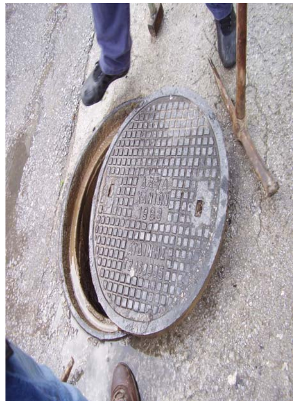
Εικόνα 19 :Το καπάκι του αγωγού στο Parking στη Μίνωος
