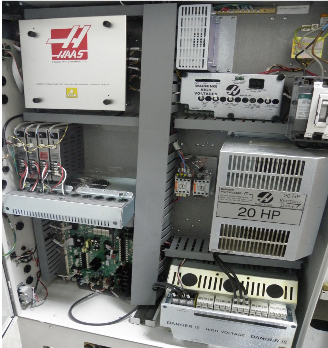
Εικόνα 20. Πίνακας ηλεκτρολογικού - ηλεκτρονικού εξοπλισμού.
