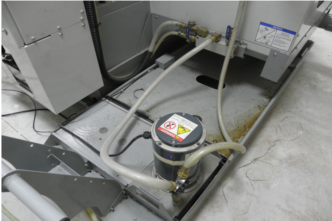
Εικόνα 19. Αντλία ψυκτικού υγρού και δεξαμενή αποθήκευσης.
