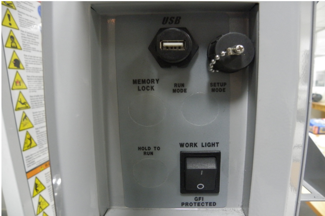
Εικόνα 23. Θύρα USB και διακόπτης φωτισμού.
