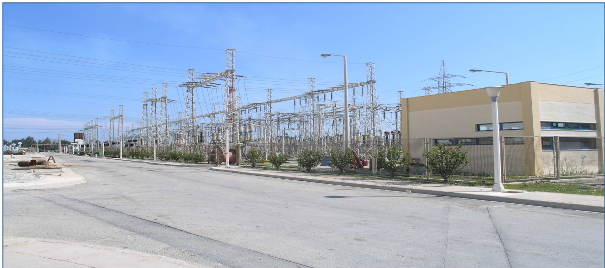
Εικόνα 3.1: Ανοικτός υποσταθμός Σορώνης
