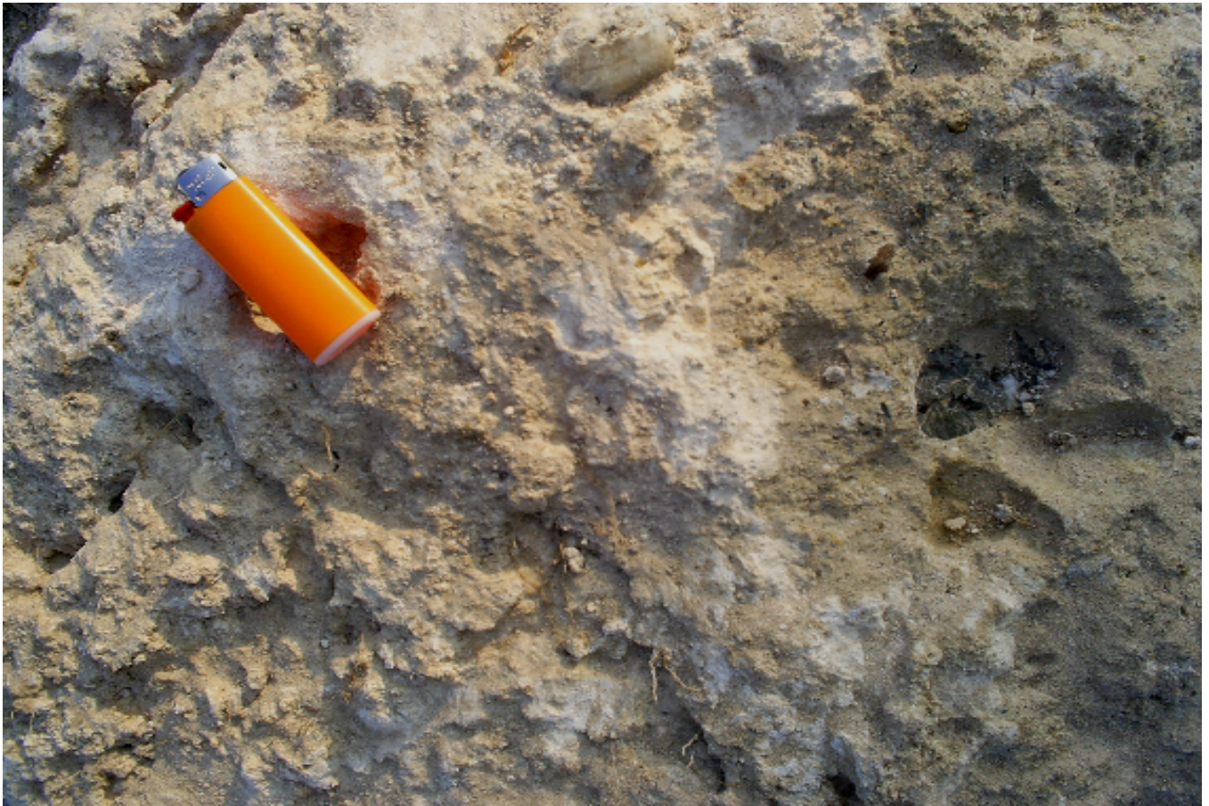
Φωτογραφία 2. Τέμαχος συμπαγούς μάργας από εκσκαφή εντός του οικοπέδου έρευνας. Διακρίνονται οι θέσεις όπου υπήρχαν κροκαλοπαγή.
