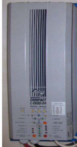
Σχήμα 48 Μετατροπέας Inverter STUDER
