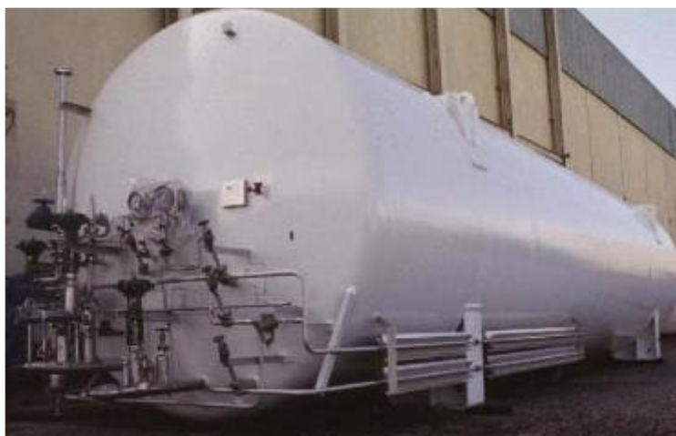
Εικόνα 4 : μονωμένη και με διπλά τοιχώματα δεξαμενή υγρού υδρογόνου
